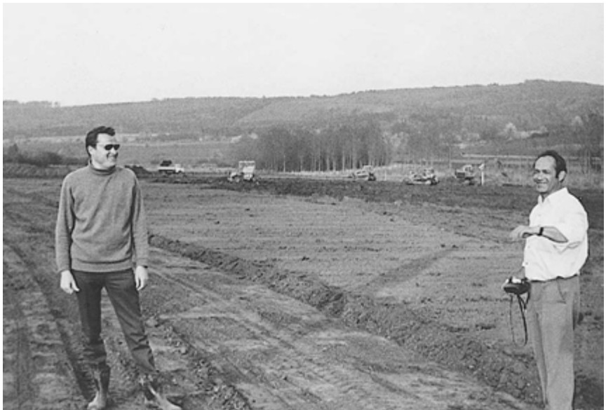
März 1971: Auf dem Gelände Altdorf Wallburg beginnen die Planierarbeiten. v. l. Horst Schneider und Erwin Haas.
